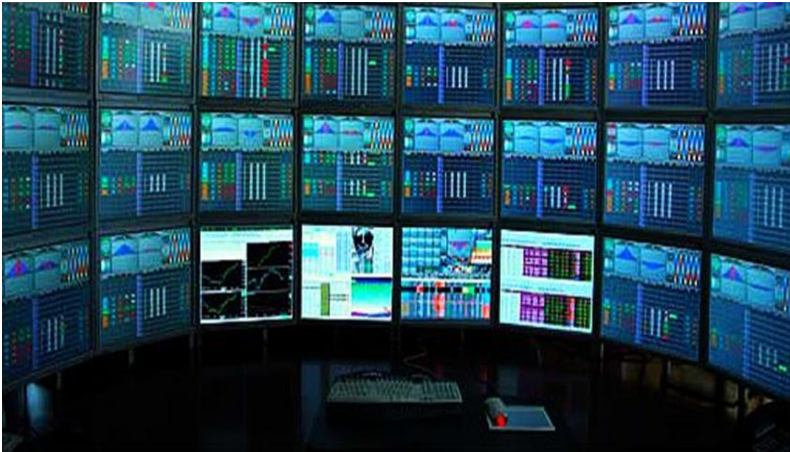
Slika 10. Data Center / Kontrolna soba
